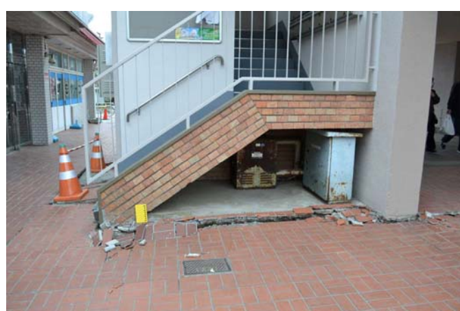
習志野市袖ヶ浦 3 丁目団地の商業棟入口の被害 地盤の陥没により建物と地面の間に亀裂やギャップが 発生した。 2011.3.14
