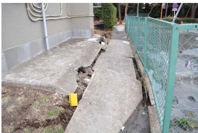
習志野市袖ヶ浦 2 丁目団地の被害 集合住宅の周囲の地盤が陥没し, 歩道との間にギャ ップが発生した。(黄色は 15cm 野帳) 2011.3.14
