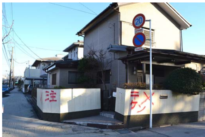
習志野市袖ヶ浦5丁目の住宅塀の被害 2011.3.13
