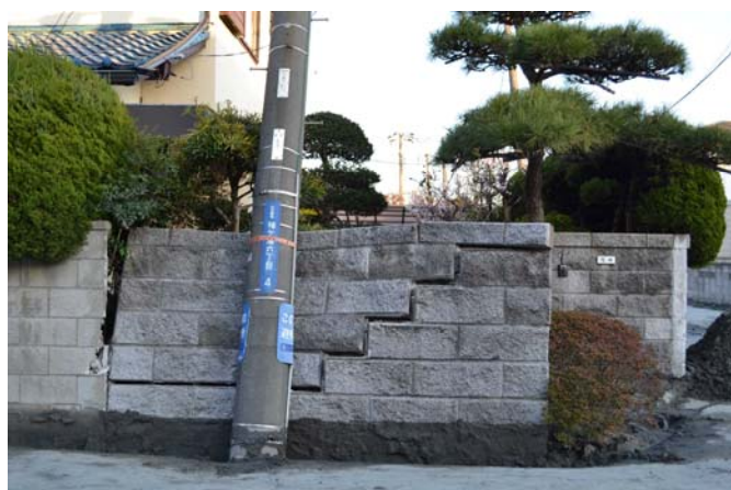
習志野市袖ヶ浦6丁目住宅地の被害 2011.3.13
