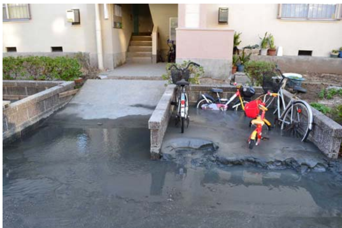
習志野市袖ヶ浦 2 丁目団地で発生した被害 地下水道管の破損, 水が道路に溢れだし断水となり, 自衛隊の給水車が連日出動した。 2011.3.14
